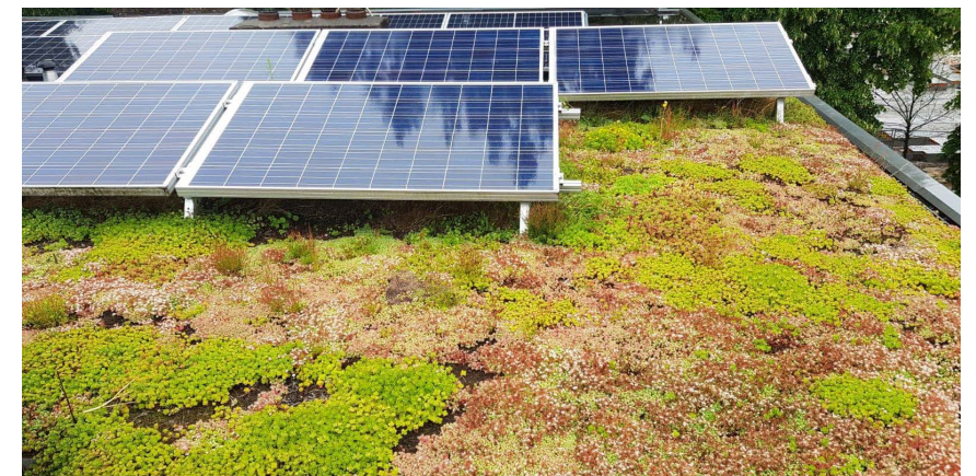
Figuur 25: Groendaken met zonnepanelen
